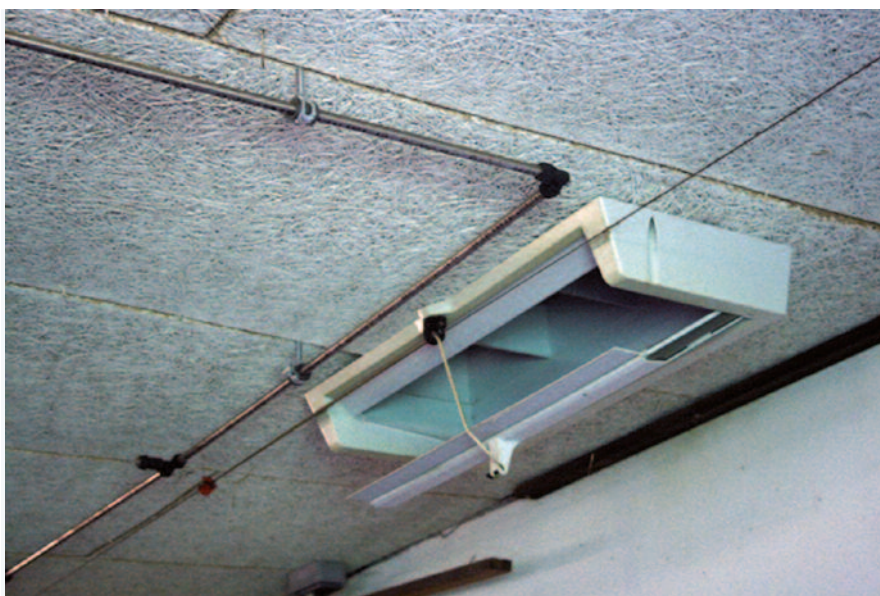
IL-luftindtag monteret i en svinestald.
